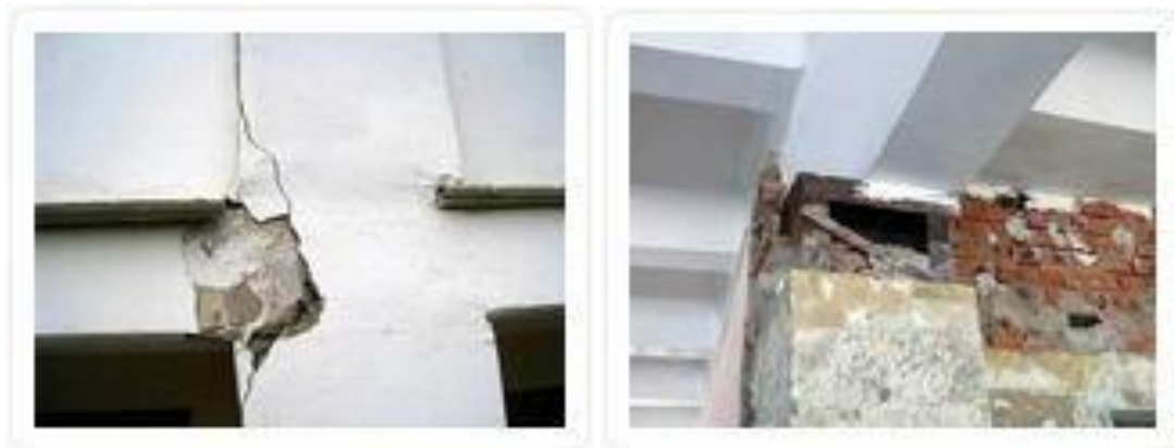
Рис. 1.1. Разрушение мест опирания несущих конструкций здания
