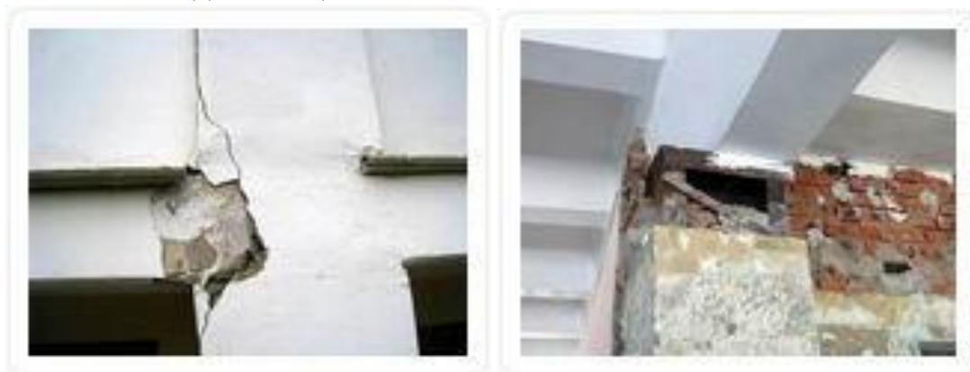
Рис. 1.1. Разрушение мест опирания несущих конструкций здания
