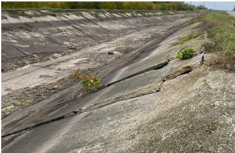
Рисунок 1 - Повреждения противофильтрационного покрытия магистрального канала 1 очереди Энгельсской оросительной системы
