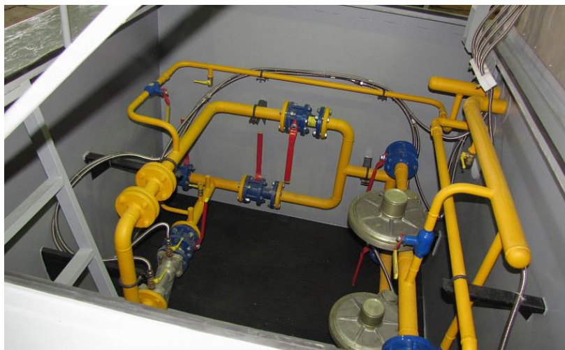
Рисунок 1 – Газораспределительный пункт, расположенный ниже уровня земли
