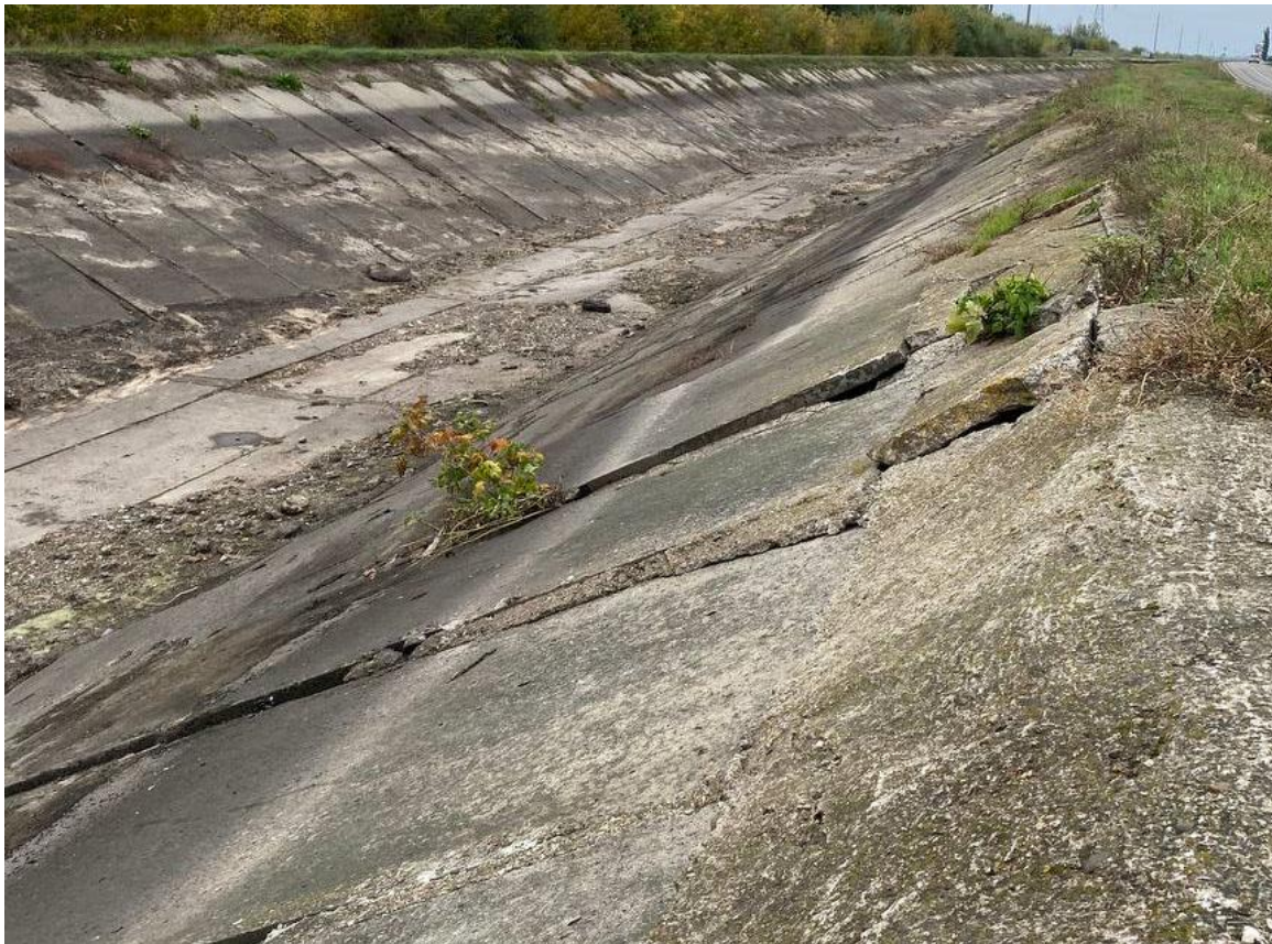
Рисунок 1. Дефекты противодиффузионной облицовки канала
