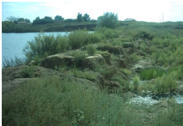
Рисунок 1. Пример разрушения гребня плотины
